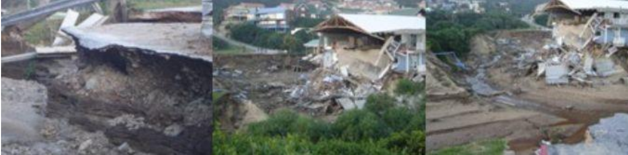
Op 1 Augustus 2006 was daar 'n groot vloed in Glentana wat die fondasies van die Glentana kafee en die parkeerarea voor dit weggespoel het
